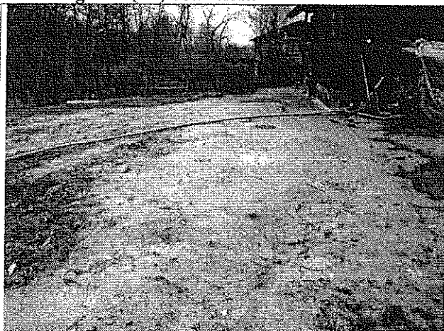
Miejsce „zasypanego” osuwiska obok budynku mieszkalnego Żabia I.
