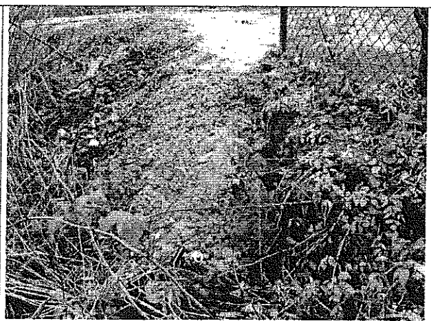
Fragment zachowanej skarpy głównej i uszkodzone ogrodzenie
