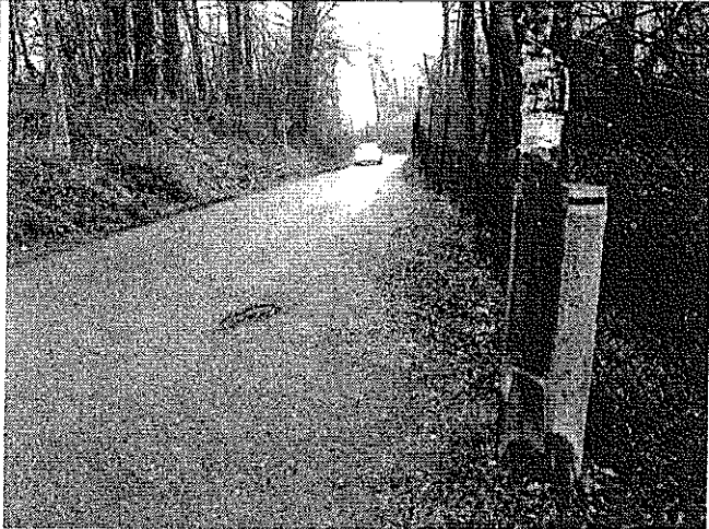
Uszkodzony fragment ogrodzenia – widok ku wschodowi
