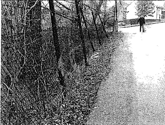
Odcinek drogi, który był uszkodzony, ze świeżym asfaltem i fragmentem uszkodzonego ogrodzenia
