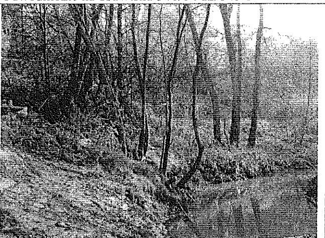
Czoło osuwiska schodzące do koryta Wilgi (widok z boku)
