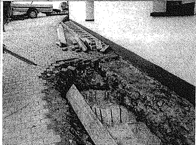
Spękania i szczeliny wzdłuż budynku nr 17
