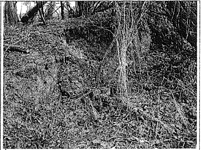
Swieża skarpa na terenie osuwiska „a”
