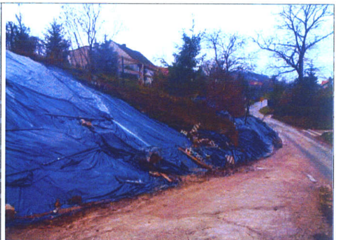
Zerwanie ogrodzenia posesji nr 51 na działce nr 82
