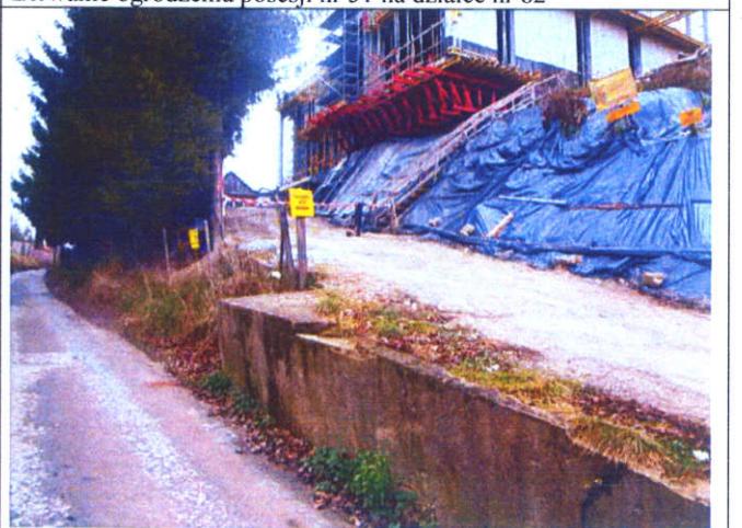
Jak obok – zagrażające konstrukcji nowobudowanego budynku
