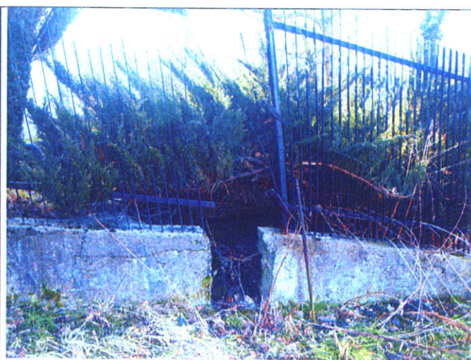
Uszkodzone ogrodzenie przez osuwisko
