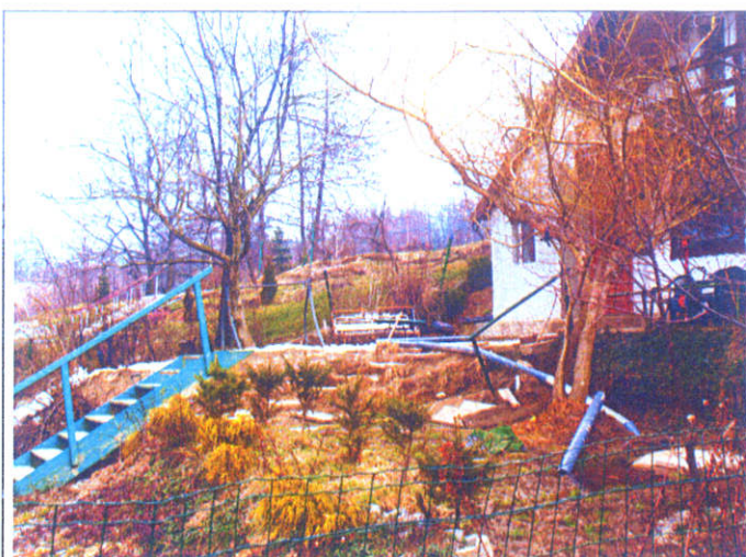
Odsunięte schody wejściowe od budynku
