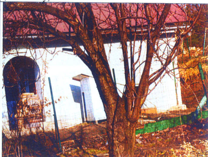
zniszczony i przemieszczony budynek mieszkalny
