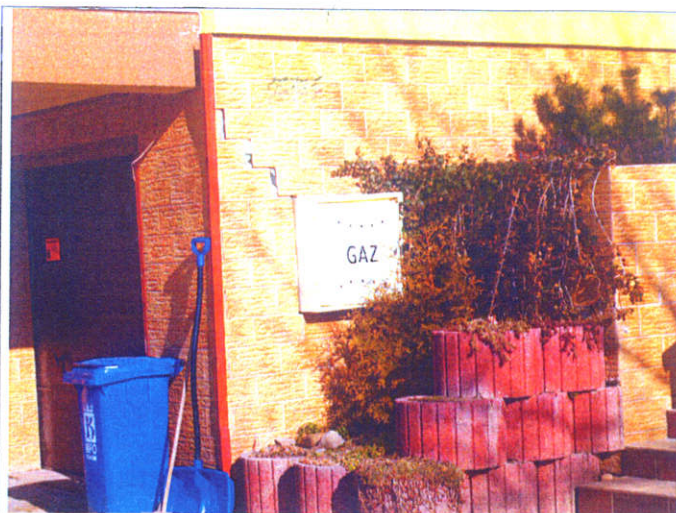
Spękania budynku 12g
