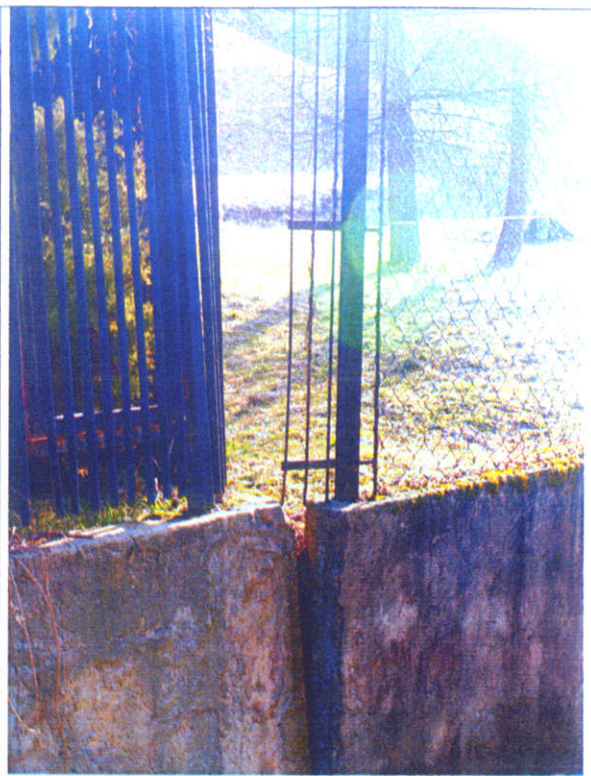
Przemieszczone ogrodzenie przez osuwisko
