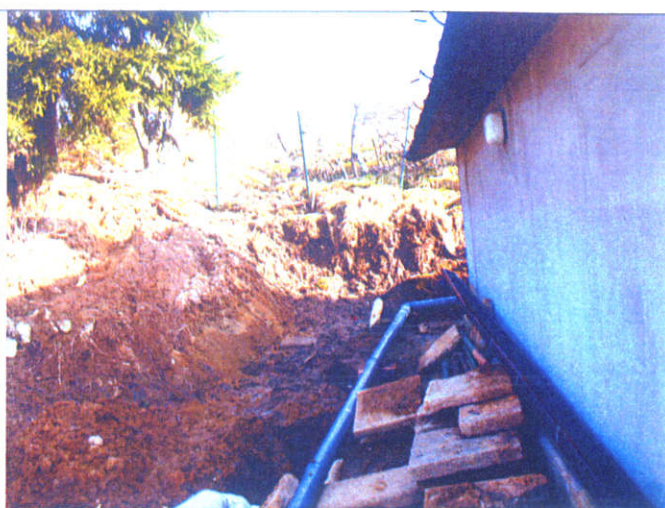
Odwodnienie koło budynku uszkodzonego przez osuwisko
