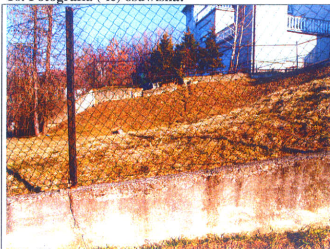
Szczelina przebiegająca przez działkę 115
