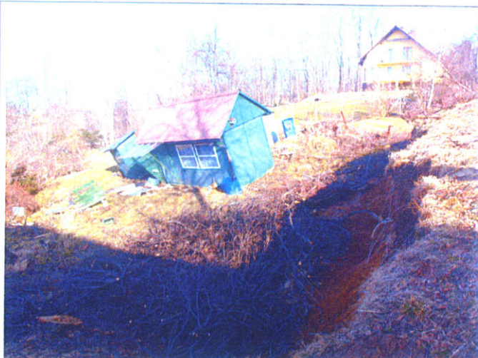
Przemieszczony budynek gospodarczy (działkowy)
