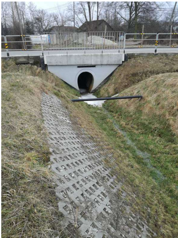
Rys. 60: Przewód gazowy przekraczający rów przy ul. Bystronia (3) (foto: III 2018).
