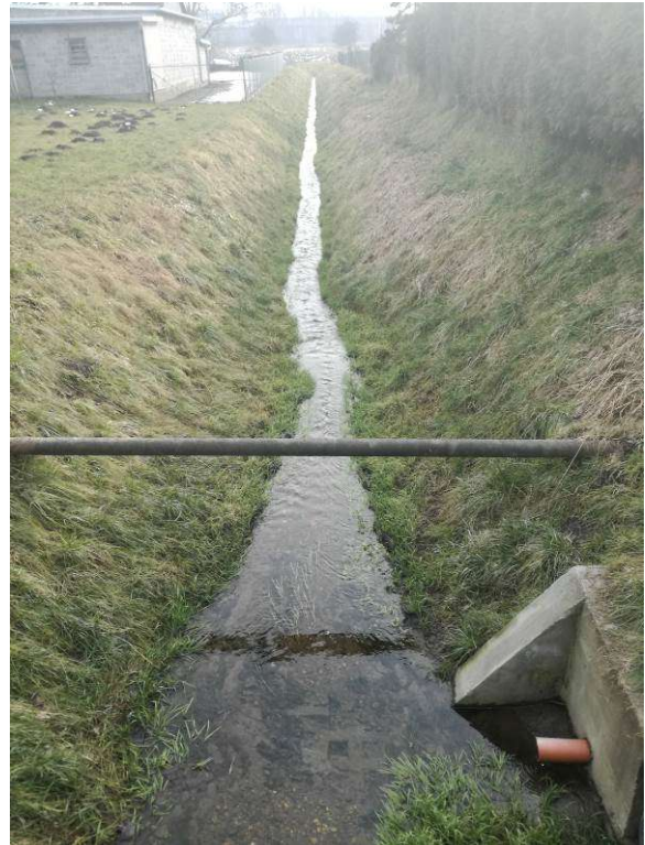
Rys. 63: Przekroczenie rowu przewodem elektroenergetycznym przy ul. Lubockiej (6) (foto: III 2018).
