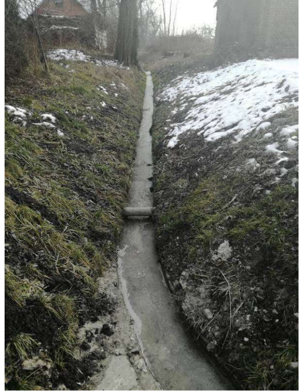
Rys. 67: Przewód gazowy przekraczający rów przy ul. Lubockiej (10) (foto: III 2018).
