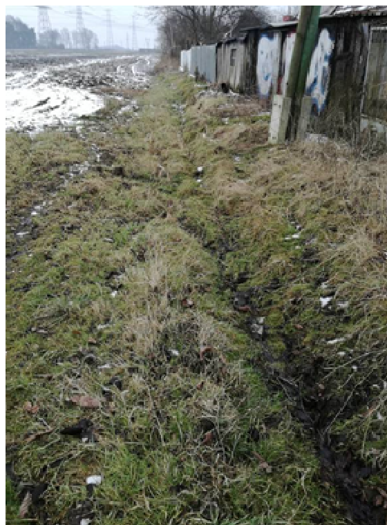
Rys. 94: Widok na pole odwadniane przez nie uzgodniony przelew do rowu „R Gz Sanoka” (foto II 2018).
