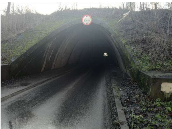
Rys. 52: Tunel pod linią kolejową przy ul. Organiki, miejsce zalewane okresowo (I 2018).
