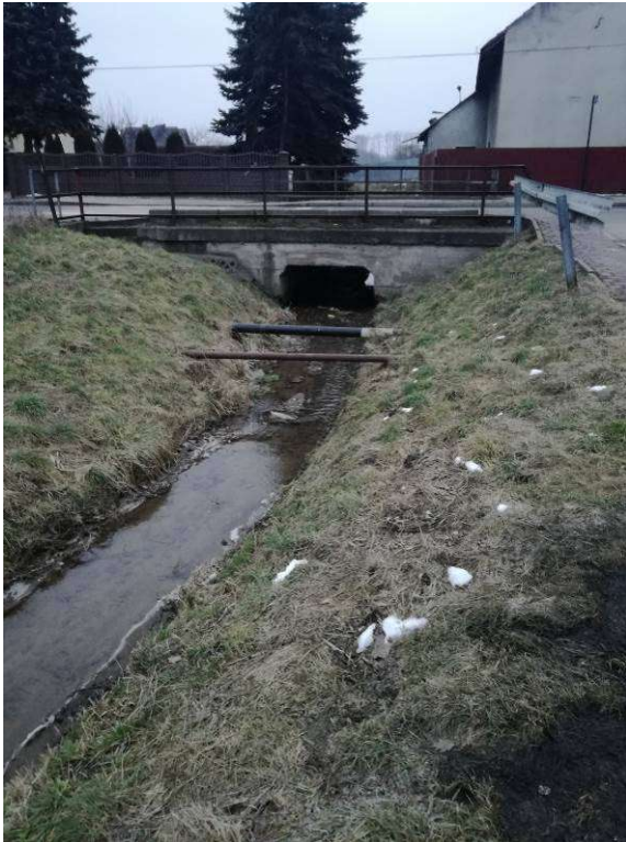
Rys. 62: Przekroczenie rowu przewodami telekomunikacyjnym oraz gazowym przy ul. Wadowskiej (5) (foto: III 2018).
