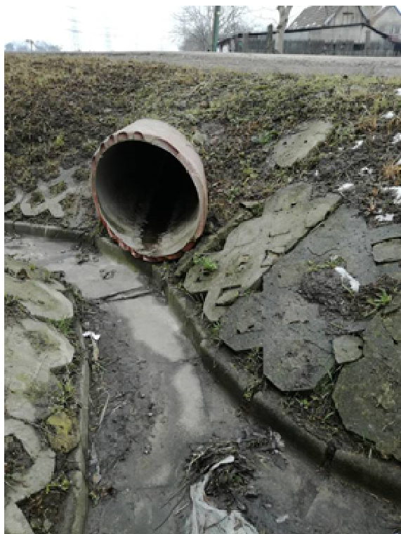
Rys. 93: Wylot nie uzgodnionego przepustu do rowu „R GzSanoka” (foto II 2018).
