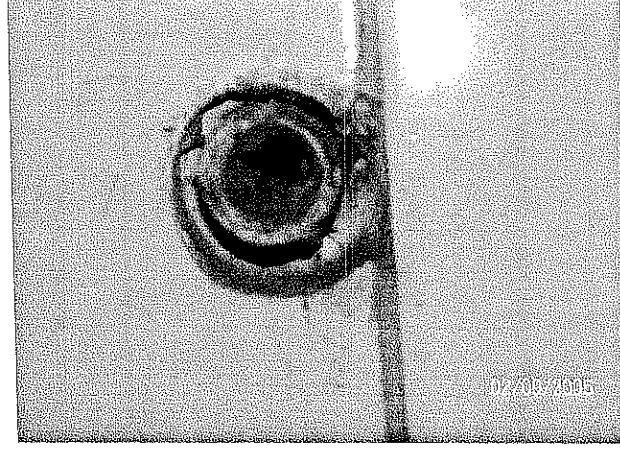
Nr.9a – zarośnięta kamieniem rura wodociągowa
