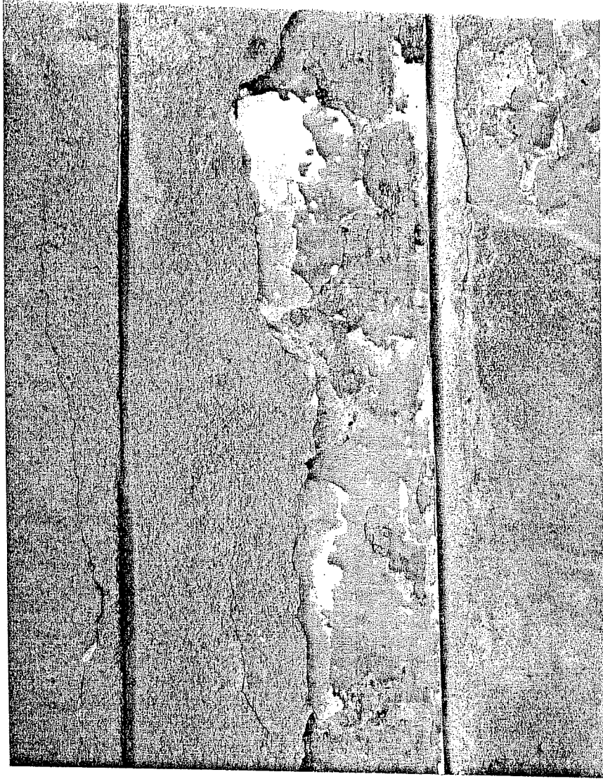
Fot. 12. Kraków, ul. Józefińska 14. Elewacja kamienicy od strony ul. Józefińskiej. Fragment. Ubytki i nawarstwienia w partii boniowania.
