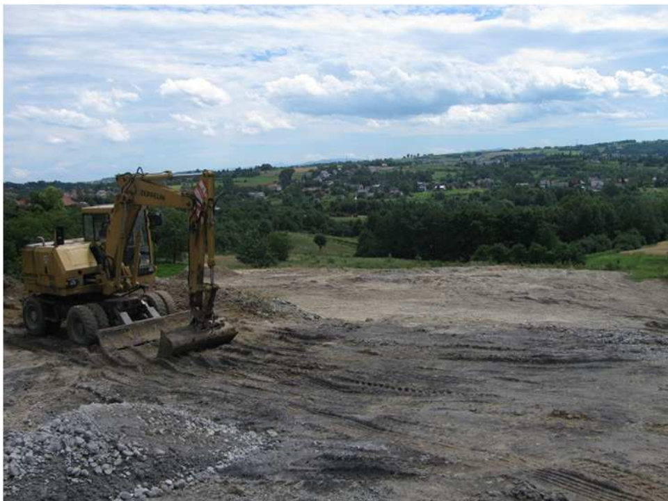
Fot.4.1. Zdjęcie zrobione z terenu budowy (nasyp budowlany), poniżej stoki osuwiskowe, Soboniowice (fot. J. Kowalczuk).
