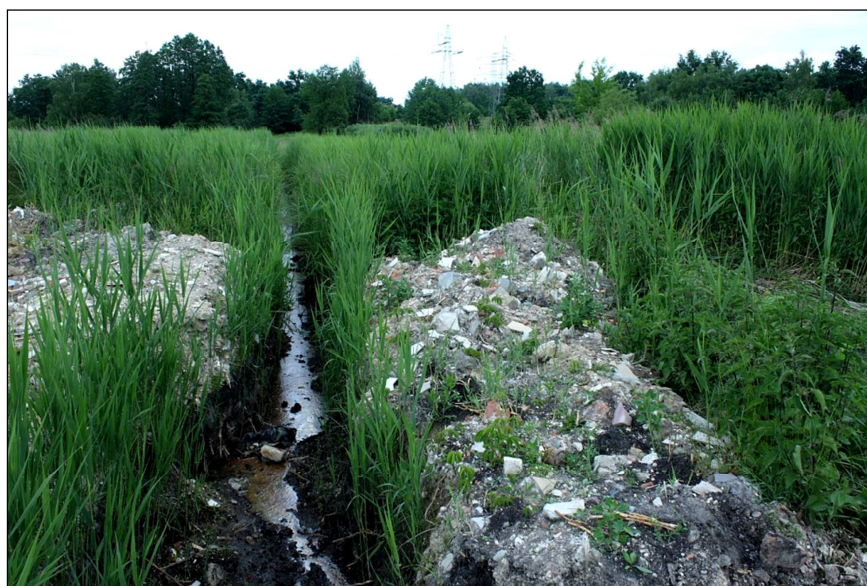
Fot. 6. Wilgotne łąki Bieżanów-Kwatery – osuszanie i utwardzanie terenu, rejon ul. Zalipki, widok w kierunku północno-wschodnim, 12.06.2016 r.
