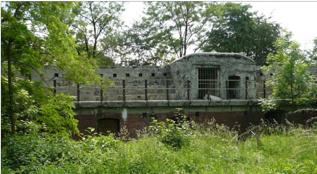
Fot. 13. Niszczący fort Skotniki 52 ½ S.
