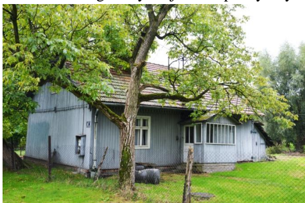
Fot. 12 Podniszczony budynek mieszkalny.
