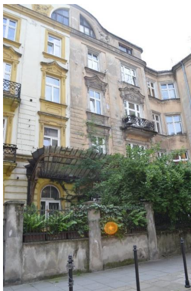
Fot. 6. Zarośnięty ogród na froncie kamienicy przy ul. Bonerowskiej.
