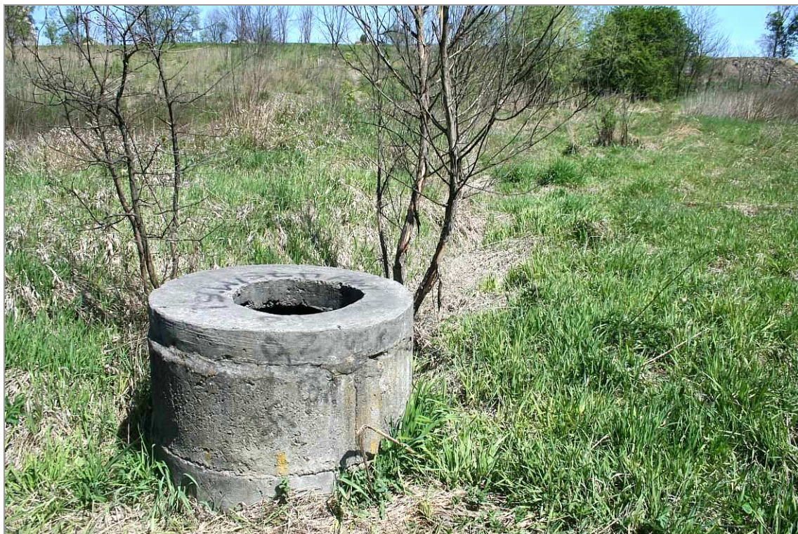
FOT. 3. ZANIEDBANY STOK PONIŻEJ SANKTUARIUM (maj 2007 r.).
