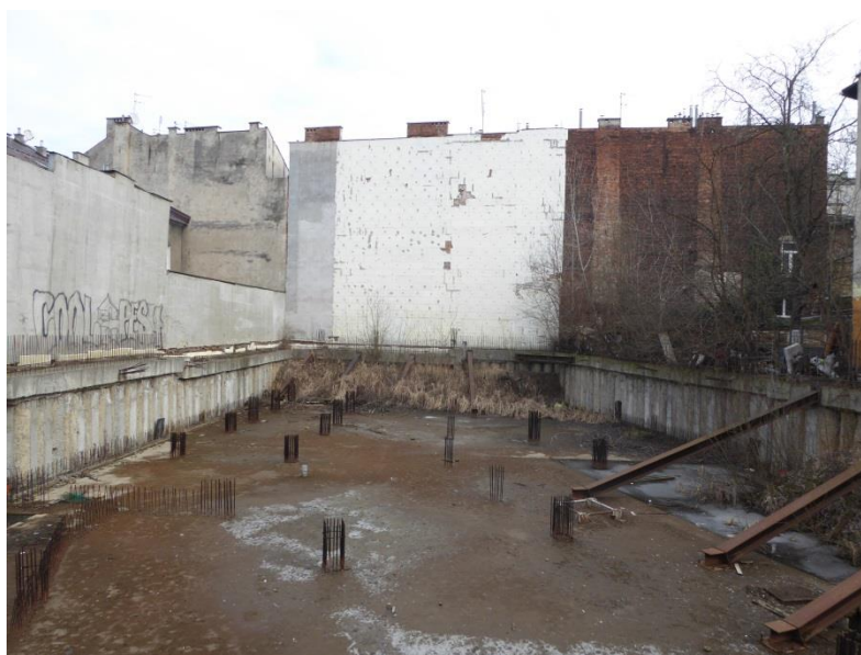
Fot. 6. Porzucona budowa przy ul. Lwowskiej.
