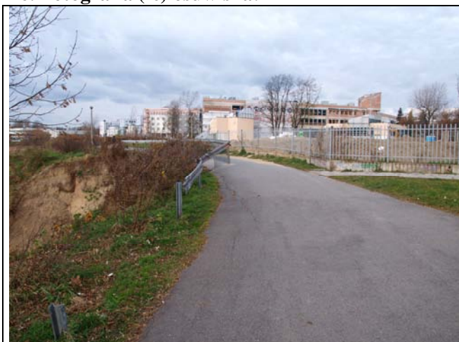
Widok na skarpe osunięcia oraz zniszczenie ścieżki spacerowej
