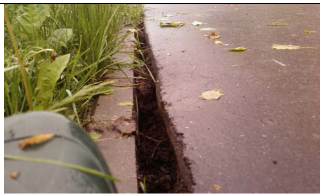
Zerwanie i obniżenie krawężnika ścieżki
