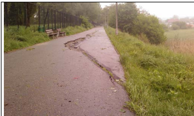
Zerwanie gruntu i obniżenie korony ścieżki
