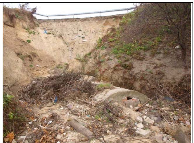
Widok od dołu na niszę osunięcia
