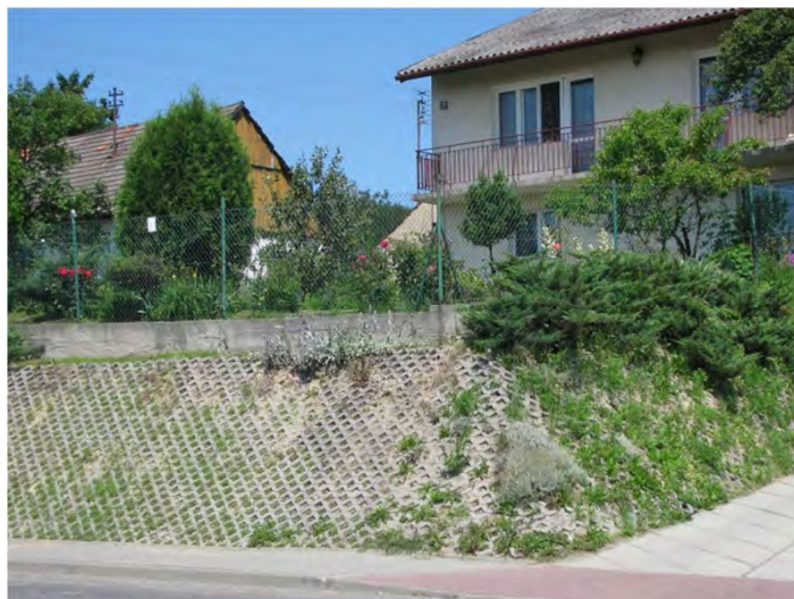
Fot.2.17. Umocnienie skarpy, poniżej znajduje się stok osuwiskowy, Soboniowice (fot. J. Kowalczyk).
