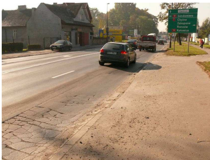
Fot.3.1. Koleiny i wyboje w nawierzchni ul. 29 Listopada, w głębi reklamy wielkopowierzchniowe.
