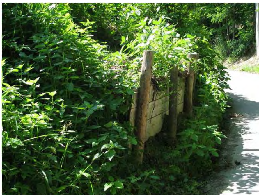
Fot. 2.18. Zabezpieczenie przed osuwaniem się ziemi (zabudowania powyżej) oraz przed przedostaniem się materiału na drogę, Rajsko (fot. J. Kowalczyk).
