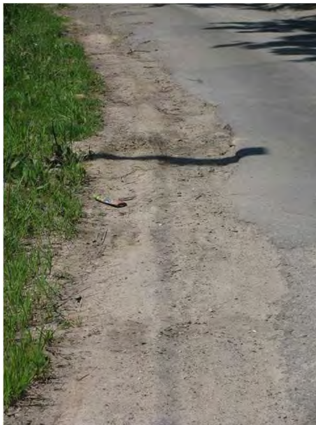
Fot.2.13. Krawędź ul. Osterwy powyżej stoku osuwiskowego (fot. J. Kowalczyk).
