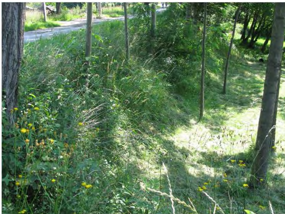
Fot.2.12. Osuwisko przy krawędzi ul. Osterwy – zbocze niszy osuwiskowej (fot. J. Kowalczyk).
