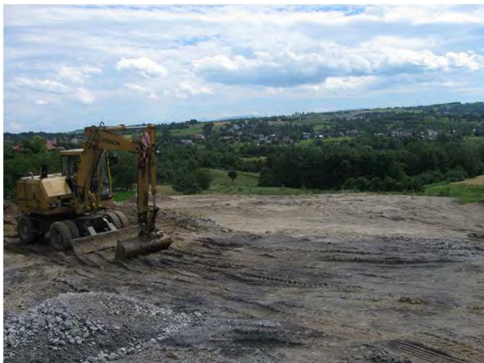
Fot.2.15. Zdjęcie zrobione z terenu budowy (nasyp budowlany), poniżej stoki osuwiskowe, Soboniowice (fot. J. Kowalczuk).
