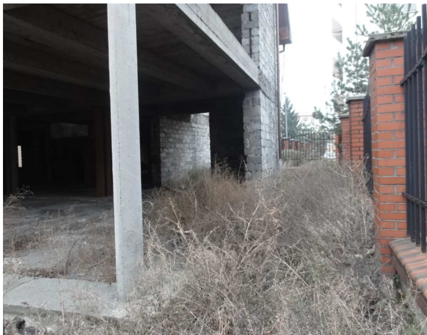
Fot. . Niedokończone zamierzenie budowlane przy ul. Kazimierza Wielkiego z roślinnością o charakterze ruderalnym.
