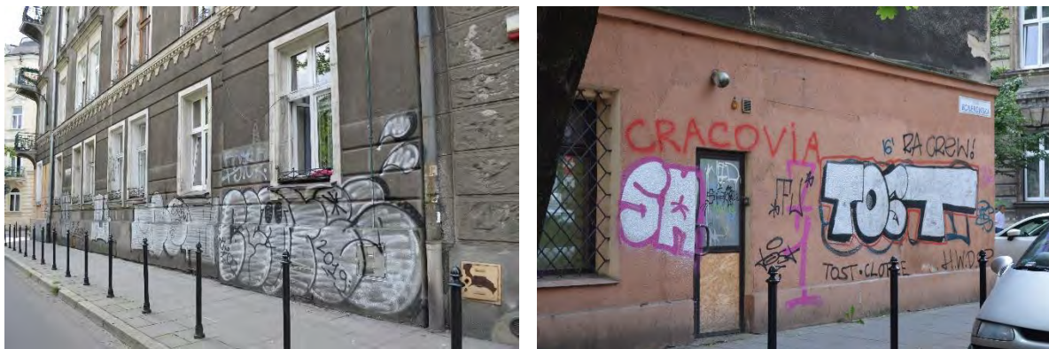
Fot. 50, 51, 52, 53 Zdewastowane mury budynków.
