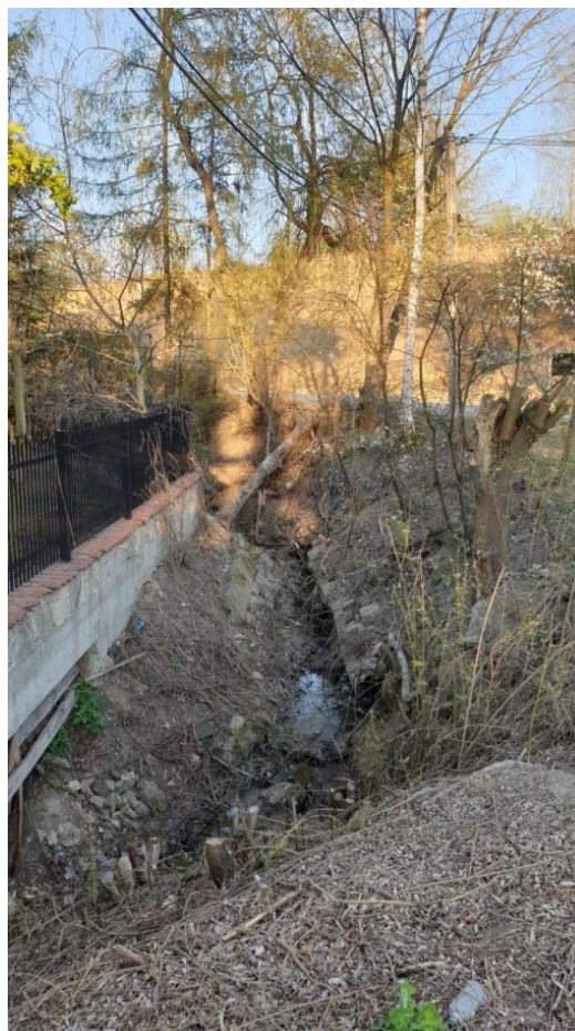
Fot. 29. Rozpoczęcie robót wiązało się ze znaczną dewastacją cieku i jego otoczenia (kwiecień, 2020 r.)
