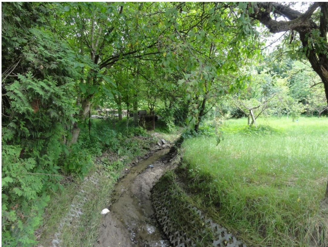
Fot. 14 Fragment otuliny biologicznej koryta potoku Młynnego Kobierzyńskiego na wysokości ulicy Gwieździstej – widok w kierunku północnym. Widoczne tereny ZPw.1, WS.1, ZPw.2 (lipiec 2021)
