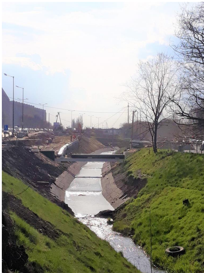
Fot. 9. Przekształcenia w obrębie koryta potoku Sudół prowadzone w związku z budową linii tramwajowej (kwiecień 2021 r.).
