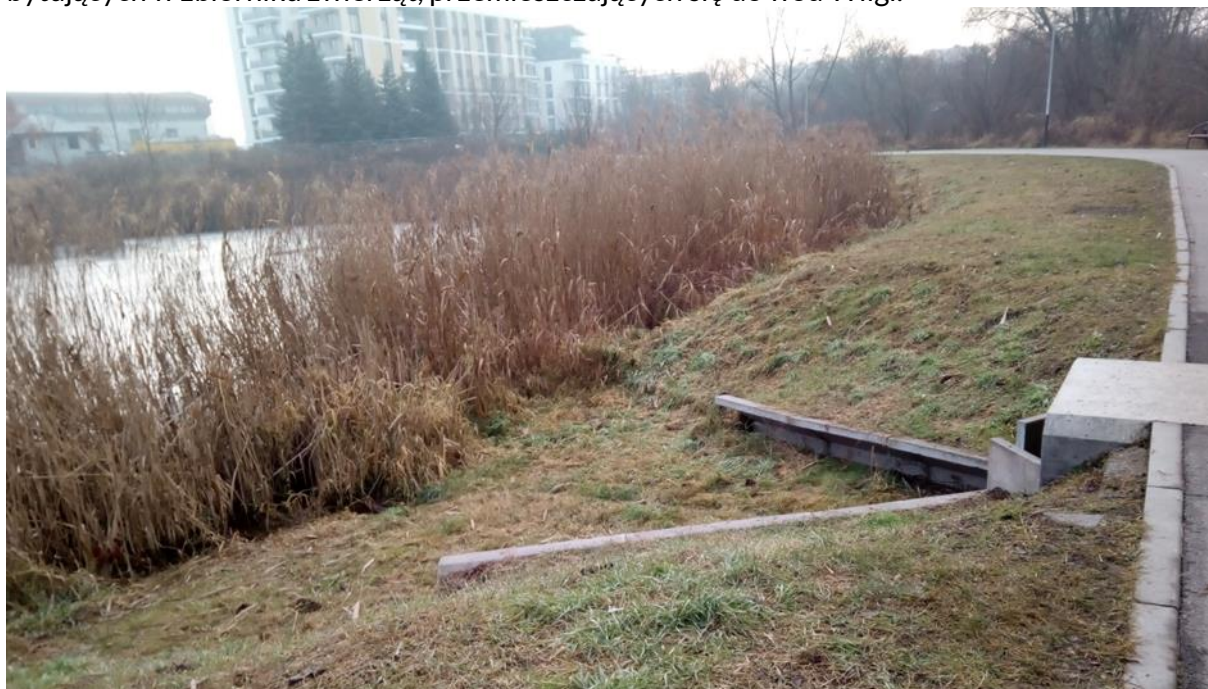
Fot. 14 Przejście ekologiczne dla zwierząt pomiędzy korytem Wilgi, a zbiornikiem wodnym, grudzień 2020 r.
