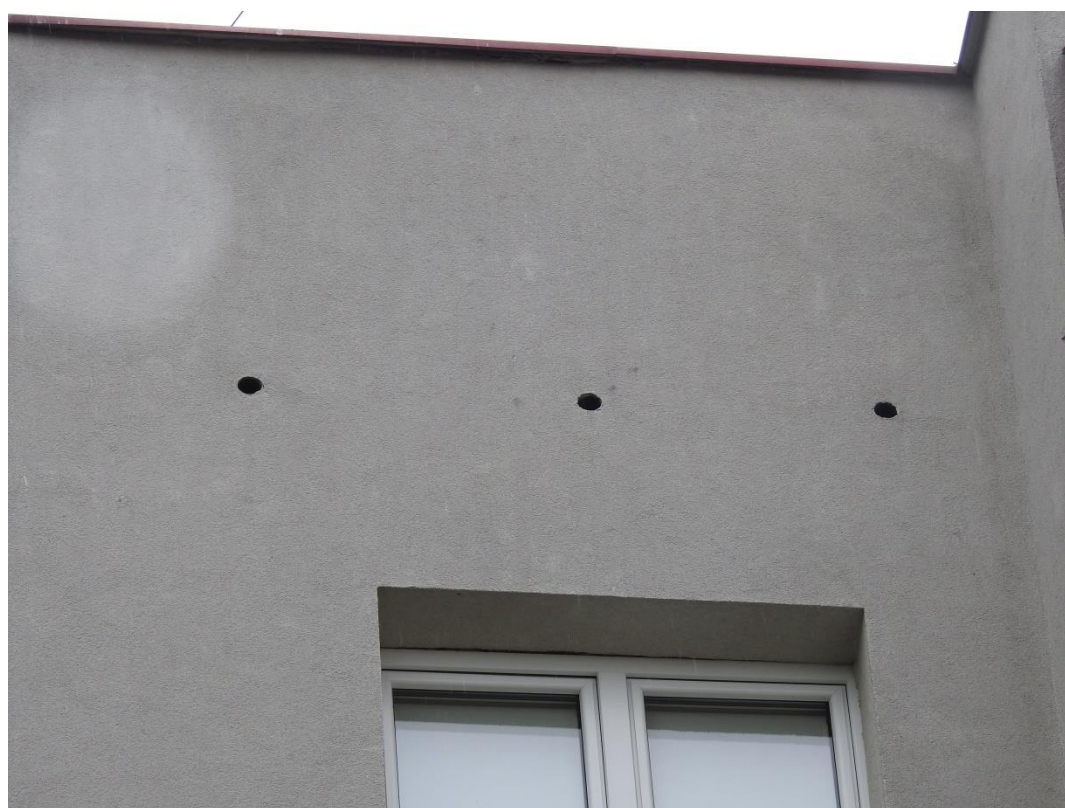
Fot. 5 Otwory prowadzące na stropodach, zasiedlone przez jerzyki i nietoperze - tu na bud. ul. Skarżyńskiego 8.
