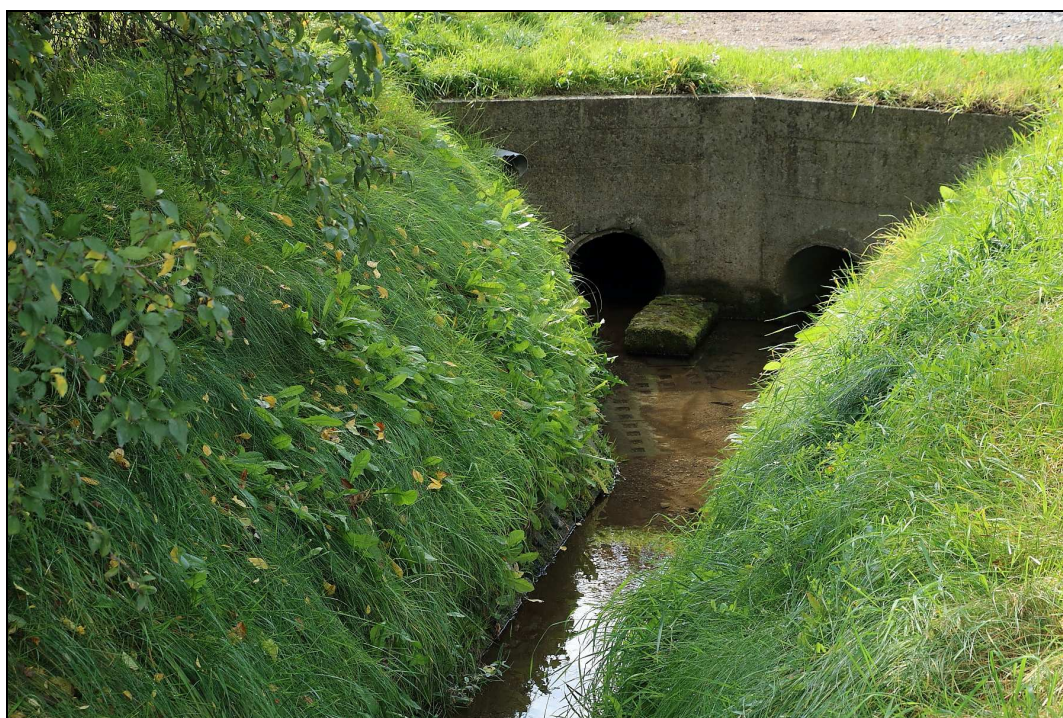
RYC. 19. RÓW PRZY UL. CHEŁMSKIEJ, BLISKO RONDA Widok w kierunku południowym, w górę biegu, 03.10.2019 r.
