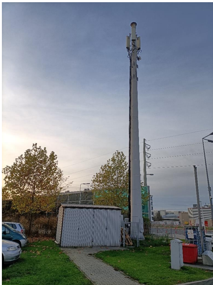
Fot. 16 Wolnostojący maszt telefonii komórkowej na terenie stacji paliw
