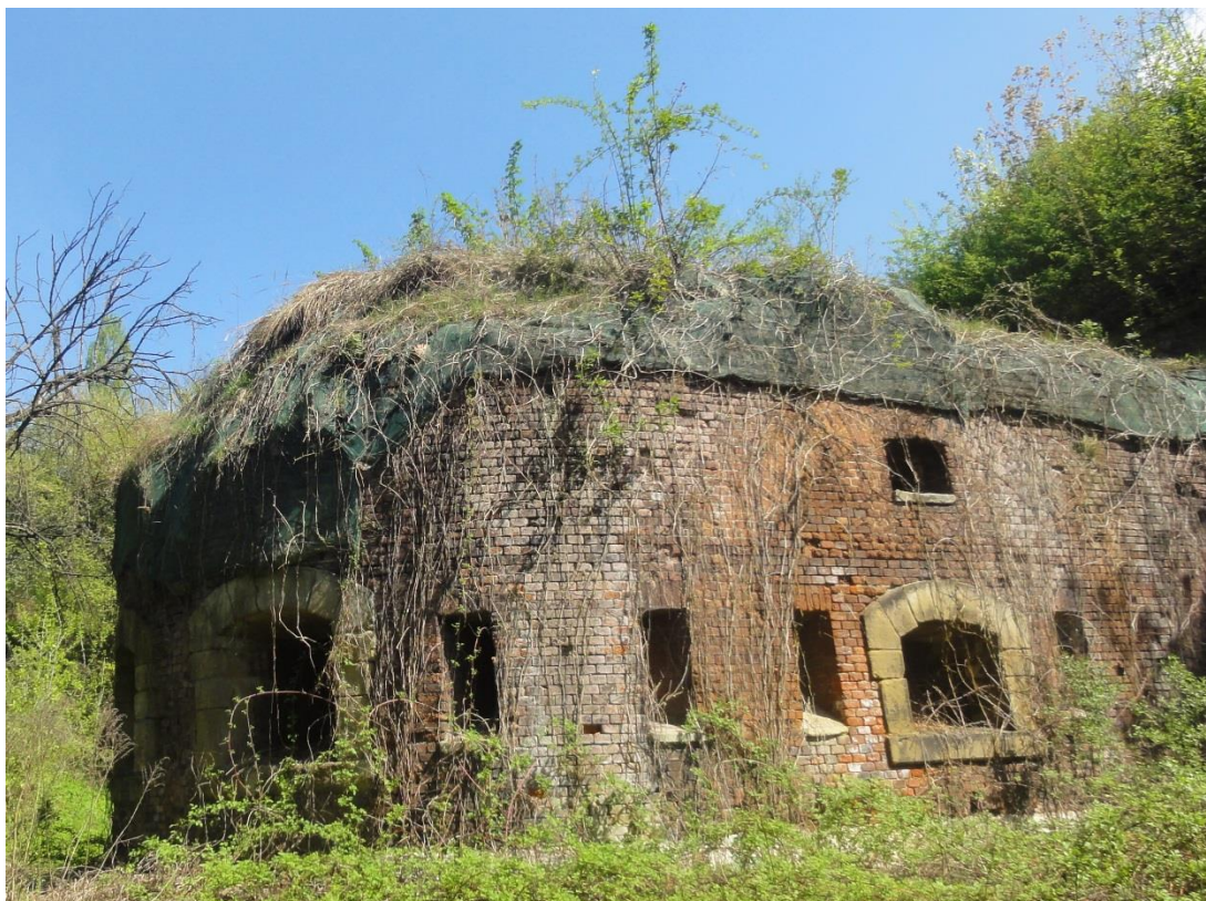
Fot. 13. Element fortu - kaponiera „Kocie Uszy” – przykład zniszczeń spowodowanych brakiem działań konserwatorskich i postępującej sukcesji (fot. Budnik A., kwiecień 2018 r.).
