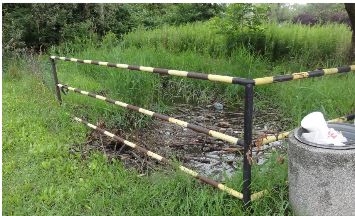
Fot. 12. Nieudrożniony przepust pod wjazdem do przedszkola przy ulicy Skośnej po intensywnych letnich opadach (fot. lipiec, 2021r.).
