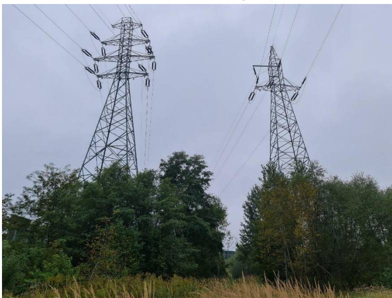
Fot. 10 Linie elektroenergetyczne przebiegające przez obszar opracowania
