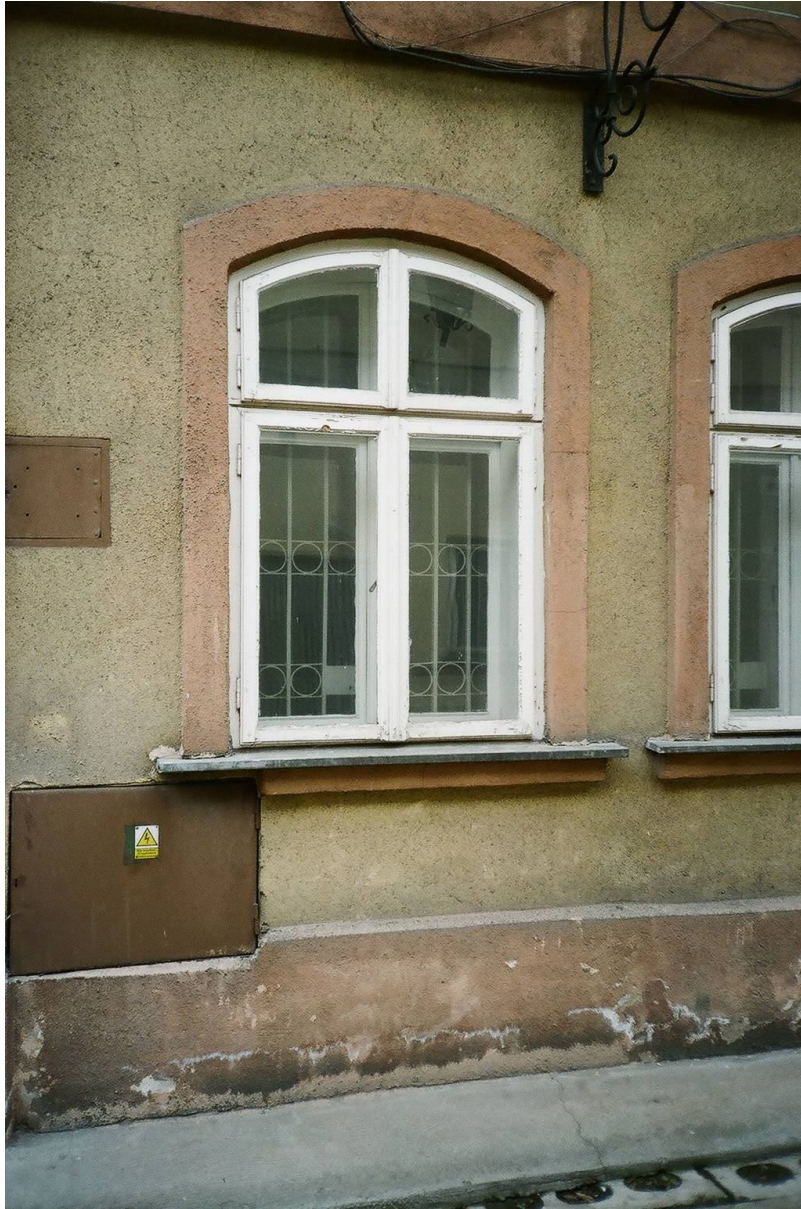
II. 14 Budynek B, stan dzisiejszy, elewacja wschodnia – okno w parterze ryzalitu na osi.
