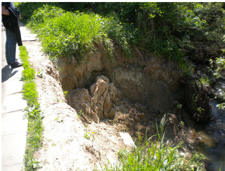
Fot.1. Teren, w którym nastąpiło osunięcie skarpy brzegu Dłubni.
