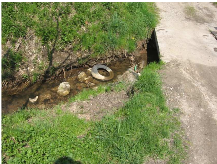
Fot.5. Przykład znaczącego stopnia zużycia urządzeń odwadniających
