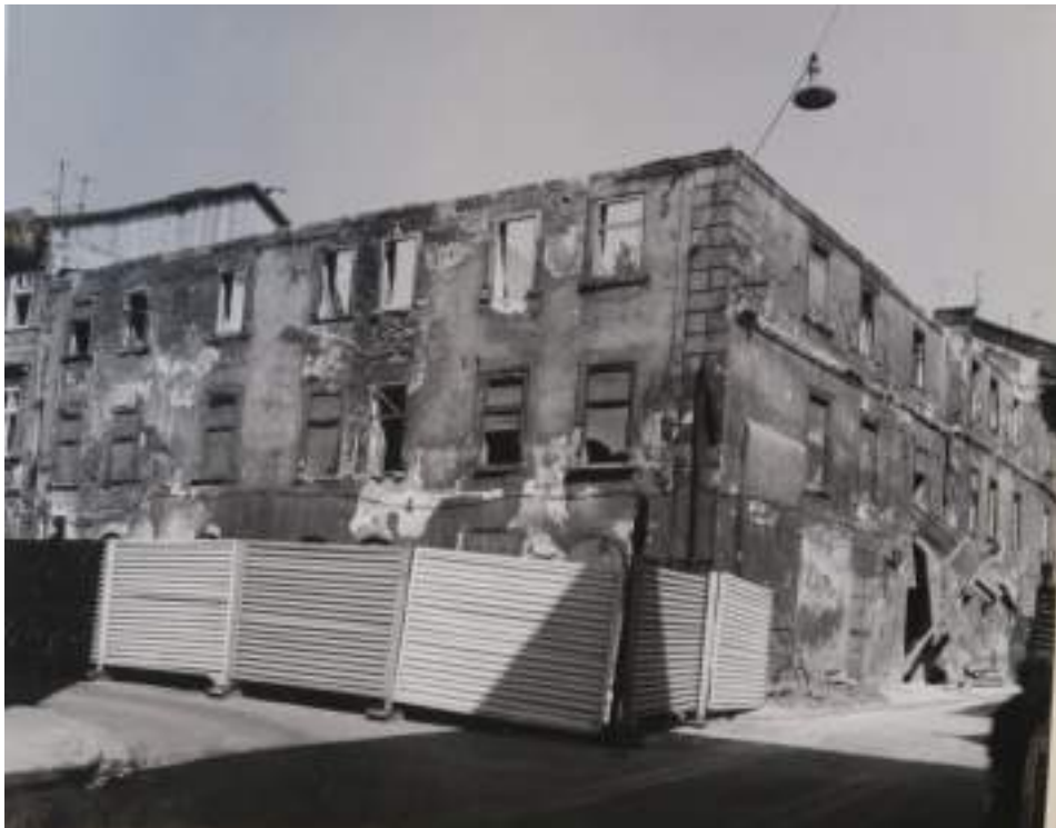
Lata 80-te XX w. – stan zachowania – wyburzenia (z dokumentacji PP PKZ, 1984)
